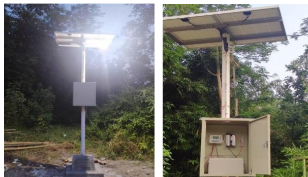
Gambar2. Sistem lampu panel surya yang sudah terinstal di lokasi
